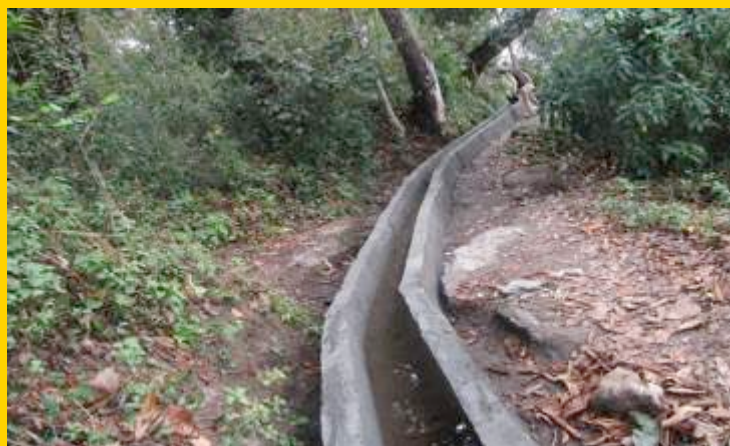
Een onderdeel van het aangelegde Betrawati irrigatiekanaal in Lagarche, Sindupalchowk die zo'n 20 boerengezinnen voorzien van water voor hun gewassen.
